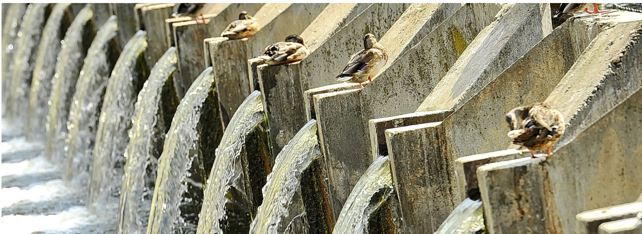
Fase de tratamiento en una planta depuradora. Las bombas de EDUR son especialmente idóneas para la flotación.
